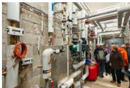
Local chaudière sous la mairie de Vialas
